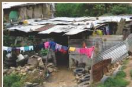
Tipología B1: Construcciones de muy mala calidad, sin fundación ni ligazón estructural.
